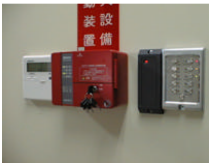
入口 (ICカード) 奥に扉 (セキュリティ認証) の 二重チェック
