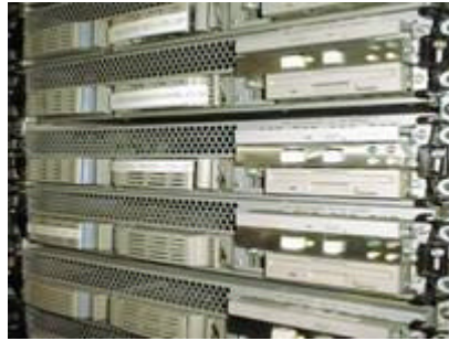
サーバラックの実装状況
